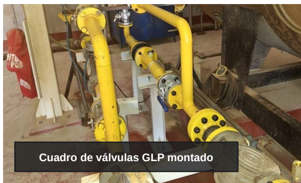
Válvula bola bridada en línea GLP
